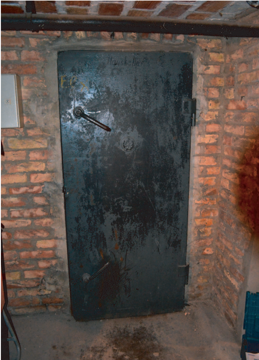
Gasdichte Stahltür im Keller Talsandweg 5 (Liepold)
