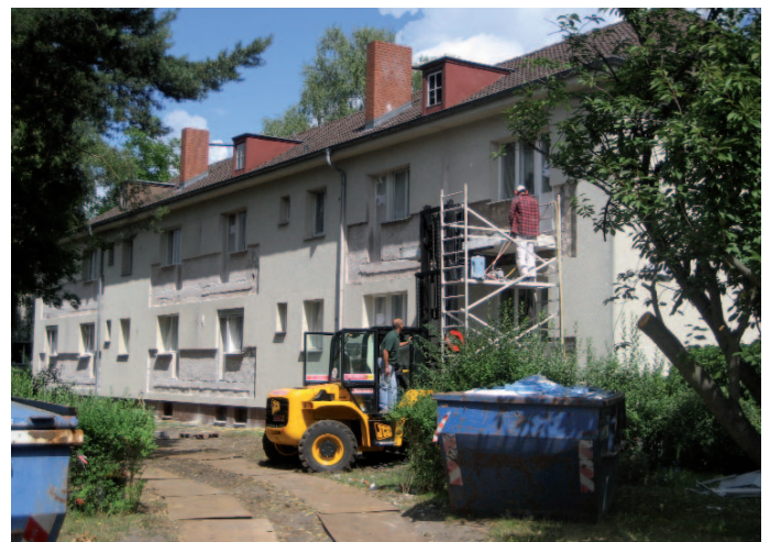
Innerhalb von 3 Tagen waren an diesem Block 12 Balkone einwandfrei entfernt. (Alle Fotos: Hans Seider)
