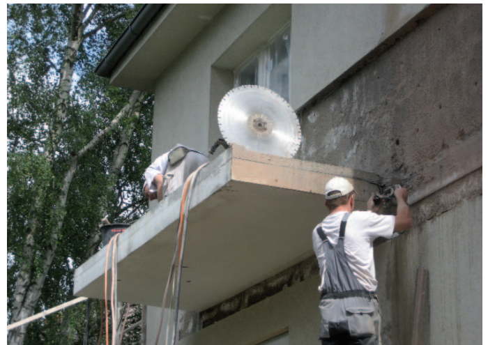
Mit einer großen Betonsäge wurden die alten Balkonfußböden sauber und ohne große Staubentwicklung abgetrennt ...
